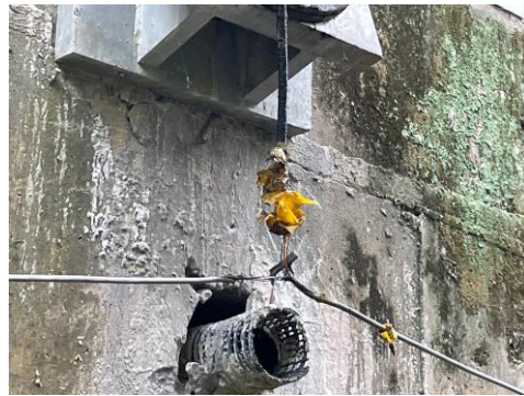
(b) 監測線路接頭處斷裂
