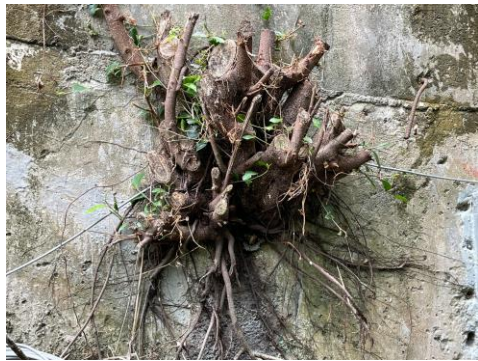
(a) 監測線路因樹木叢生而損壞
