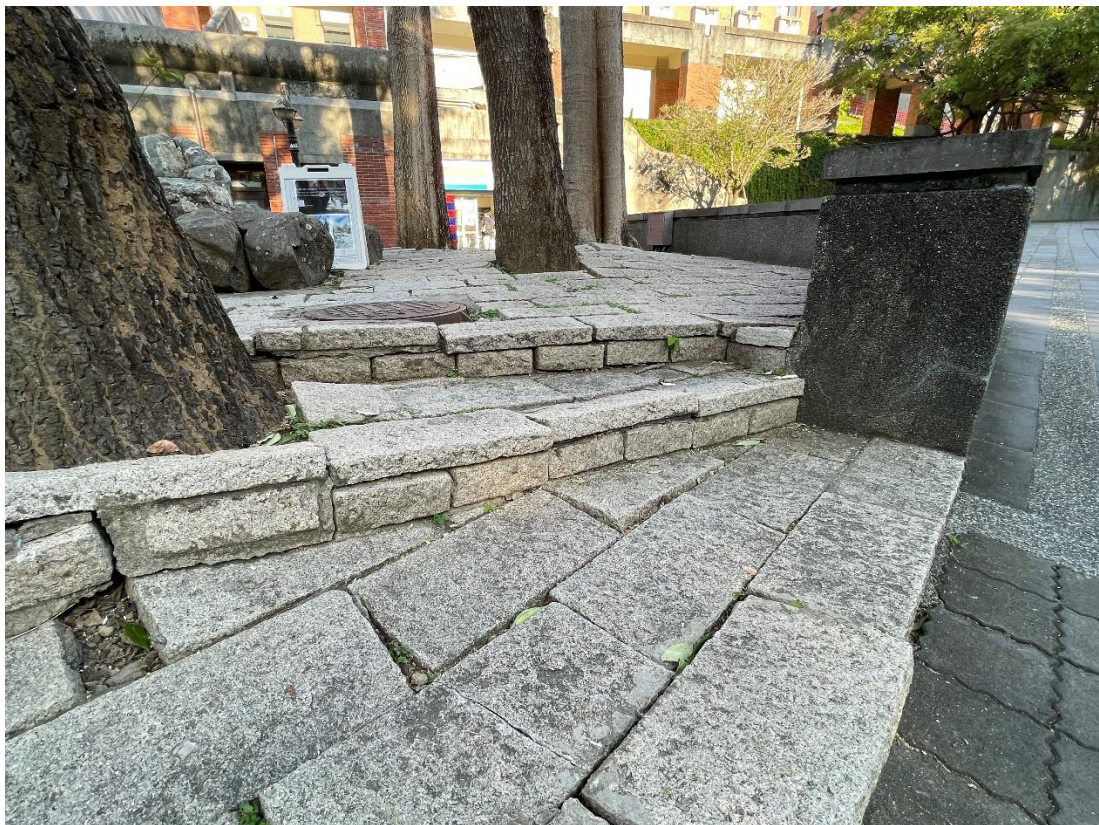
【具倒伏風險之黑板樹僅距離學餐建物約 2 公尺，且板根攏起破壞周邊石材地坪】
